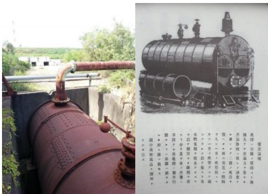
写真4 ランカシャー型ボイラーを転用した圧縮空気貯留タンク
